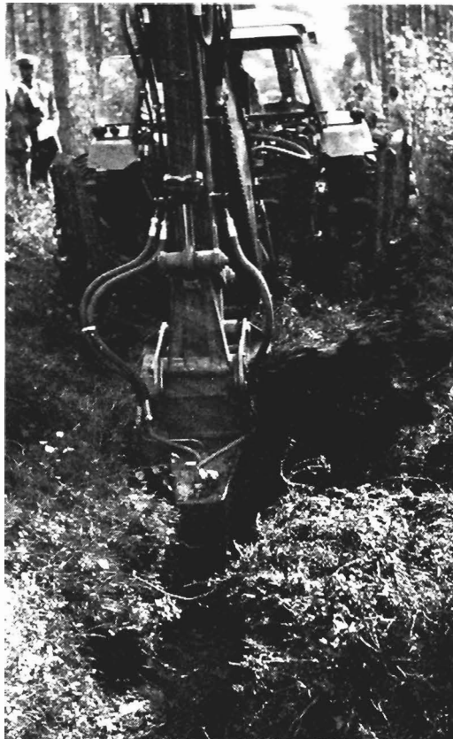
Kuva 3. Erikoiskauha, ryömintävaihe, nokkapyörä ja joustava telarakenne tekevät traktorikaivurista suorastaan metsäojituksen monitoimikoneen. Ensimmäinen tällainen yksikkö on VALTRA UM 353, jota kuvassa kokeillaan moottorikauhalla varustettuna. Valok. M. Niskanen.
